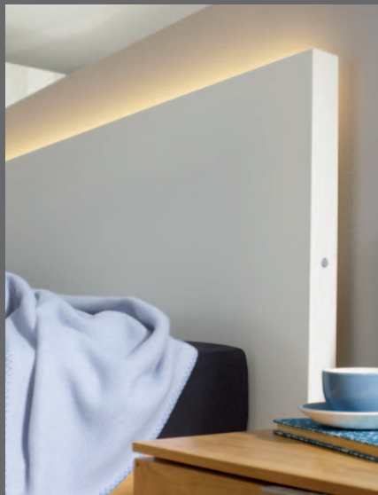
Indirekte LED-Beleuchtung mit Kontaktschalter
